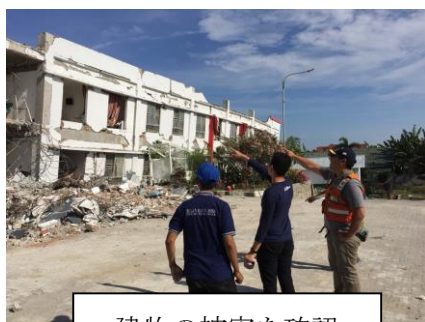
建物の被害を確認
