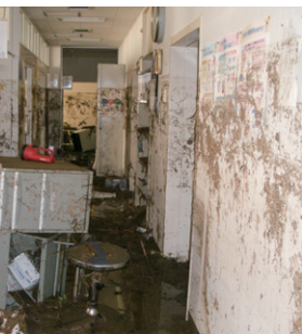
本吉病院は河川津波(川を遡った津波)で1階が浸水。水位を示す泥跡が凄まじさを表す
