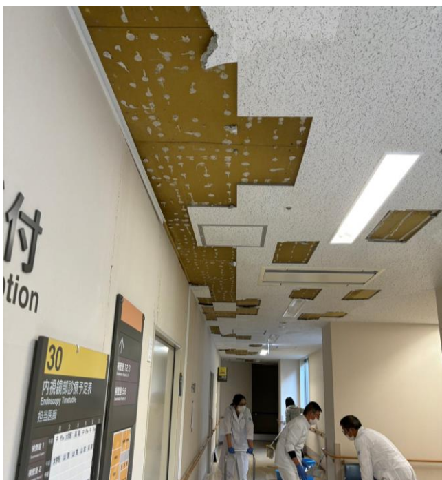
能登総合病院内 天井が剥がれ落ちている
